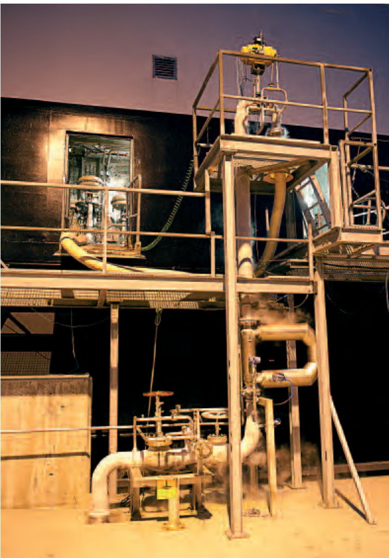
Figure 12: Gasnor LNG pipeline
